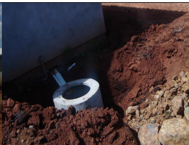
FOTO 02 – Caixa de Gordura
